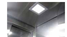
Éclairage efficace et arrêt automatique
