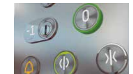
Mise en stand-by de l'ascenseur
